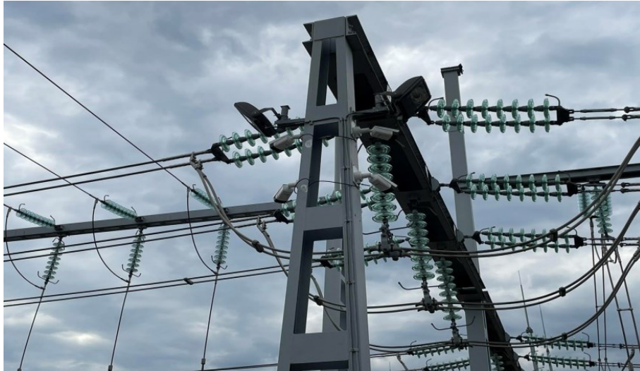
Слика бр.1 Приказ камера у постројењу
