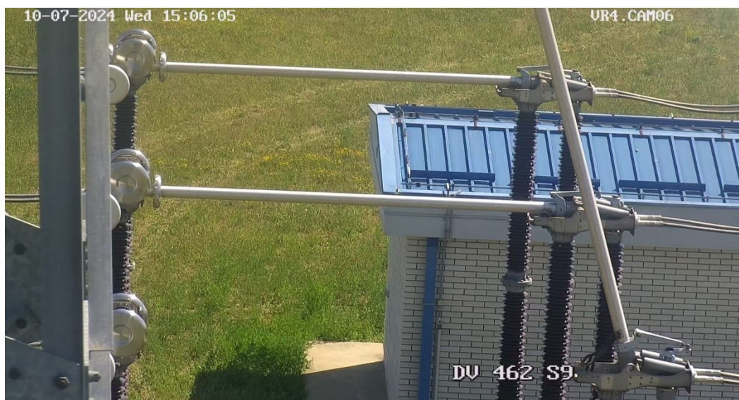
Слика бр. 3 Излазни растављач у ТС Врање 4 у ДВП 400 кV бр. 462
